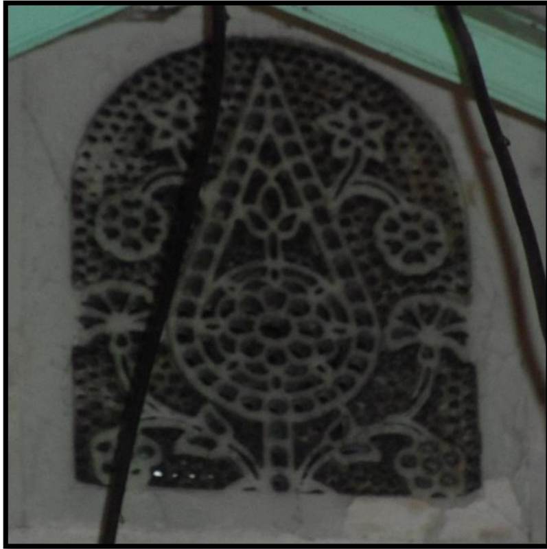
الصورة 23:شمسية تزين رقبة قبة ضريح سيدي عبد الرحمنبالجزائر تحمل زخارف نباتية قوامها أزهار ، و شجرة السرو
